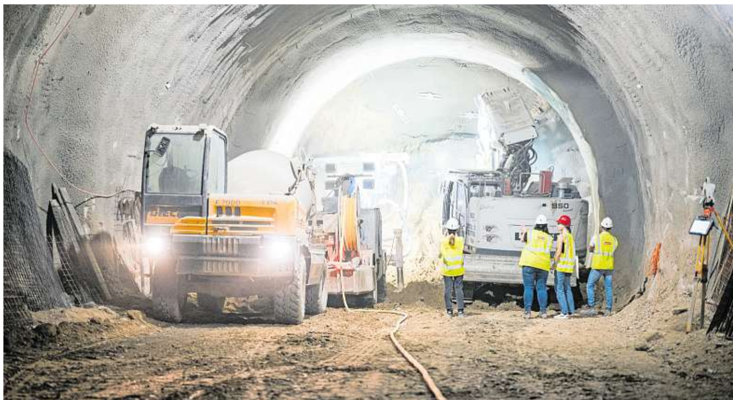
Am Frankhplatz soll bald die U-Bahn fahren, rund um die Uhr wird an den Tunneln gebaut
