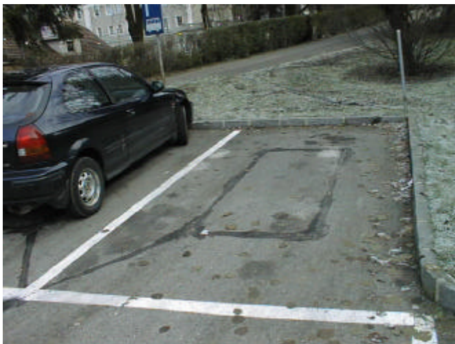
Abbildung 4: Parkplatz mit eingelassener Induktionsschleife
