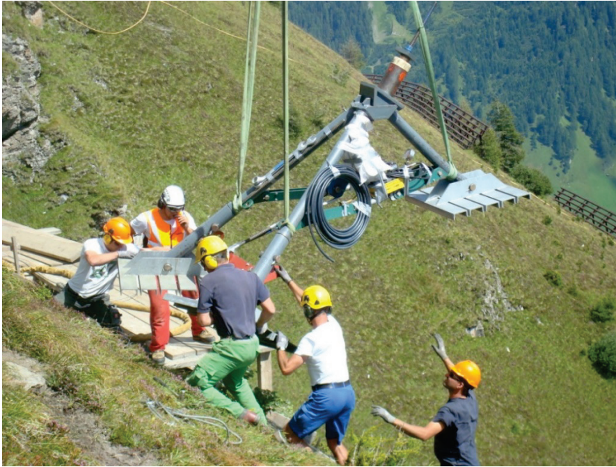
Abbildung 8: Dreibein-Prüfeinrichtung für Abnahmeprüfungen (WLV Imst).
