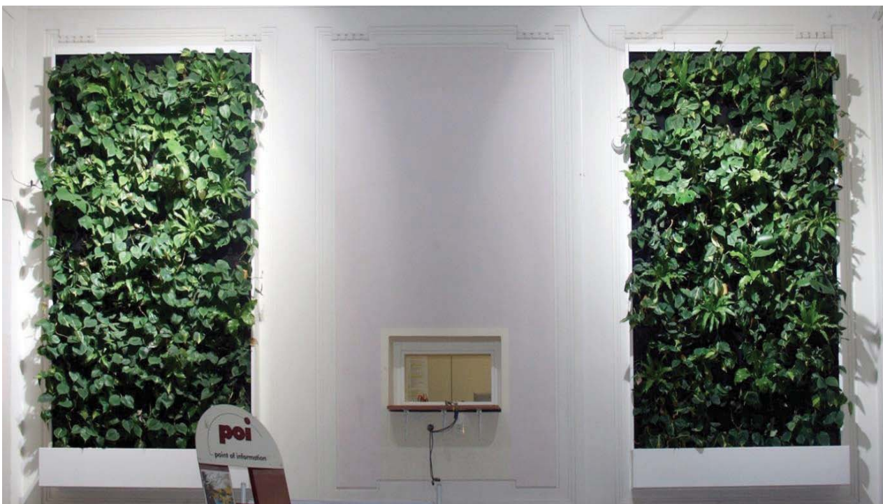
Abb. 16: Vliessystem mit Wassertank und Umlaufpumpe im Eingangsbereich.
