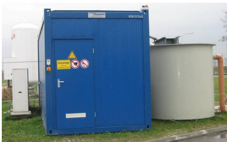
Abbildung 6 Foto der Pilotanlage mit Sauerstofftank, Kühlaggregat, 20' Container und Versuchsreaktor
