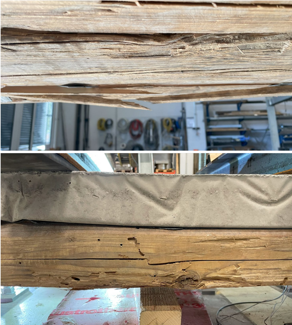
Risse im Holz
